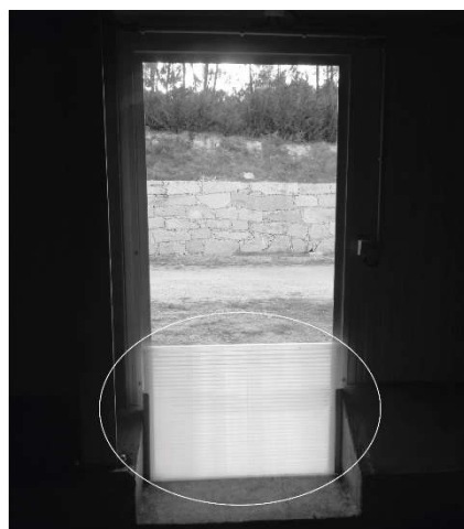
Figura 3.20. Porta lateral com proteção.
