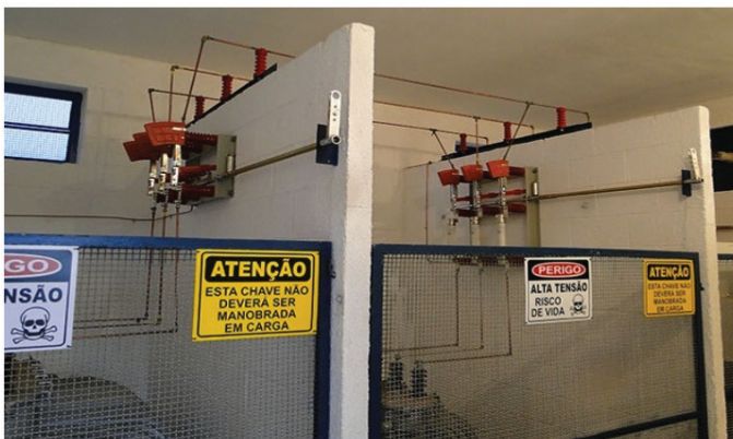
Figura 40.4 – Vedação em rede metálica para equipamentos com partes acessíveis normalmente em tensão
