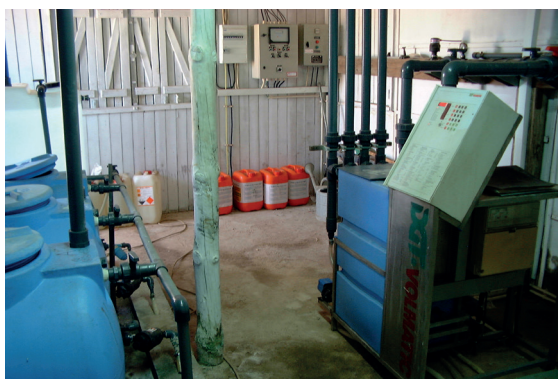
Figura 86 – Equipamentos de controlo da solução nutritiva composto por três depósitos de solução-mãe (à esquerda) e controlador da preparação da solução-mãe e da frequência e duração das regas (à direita).
