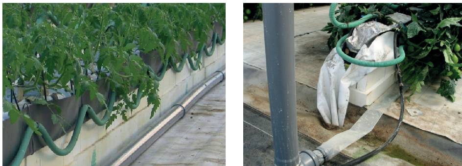
Figura 78 – Tubagem de distribuição de CO 2 ao longo das linhas de cultura, em tubo de PVC (à esquerda) e em manga de PE transparente (à direita).
