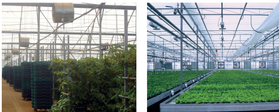
Figura 66 – Ventiladores elétricos para movimentar o ar interior da estufa (esquerda) e para extrair o ar da estufa (direita).
